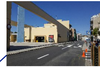
Asfaltatges dels carrers Verge del Remei, d'Àfrica, de Begoña, de Font Santa, de Núria, dels Desemparats i avinguda de la Pietat.
