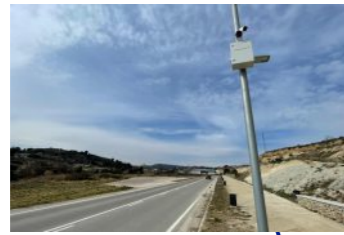
Instal·lació de càmeres de videovigilància
